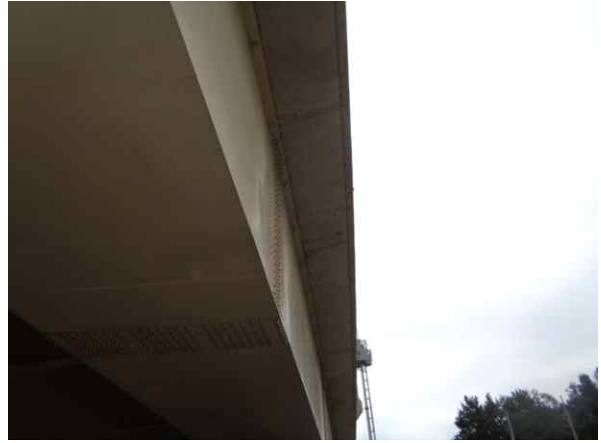
바닥판 하면 S1 캔틸레버부 상태 양호
